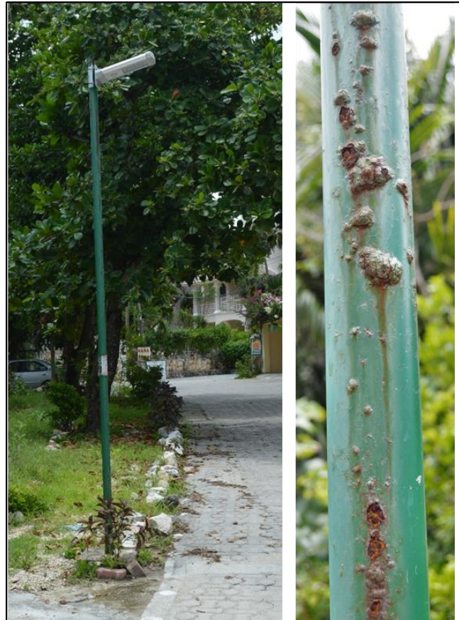
Tipo de luminarias y estado de corrosión que se observa en la mayoría de los postes. Es evidente que no cumple con las necesidades de imagen ecológica de Akumal Norte y tampoco con la función sustancial de la iluminación pública.
